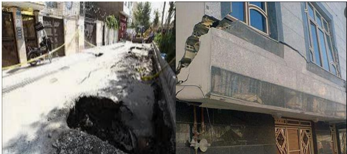
شکل ۱۱- تصاویر میدانی ایجاد ترک در ساختمان‌ها و معابر دشت پاکدشت
